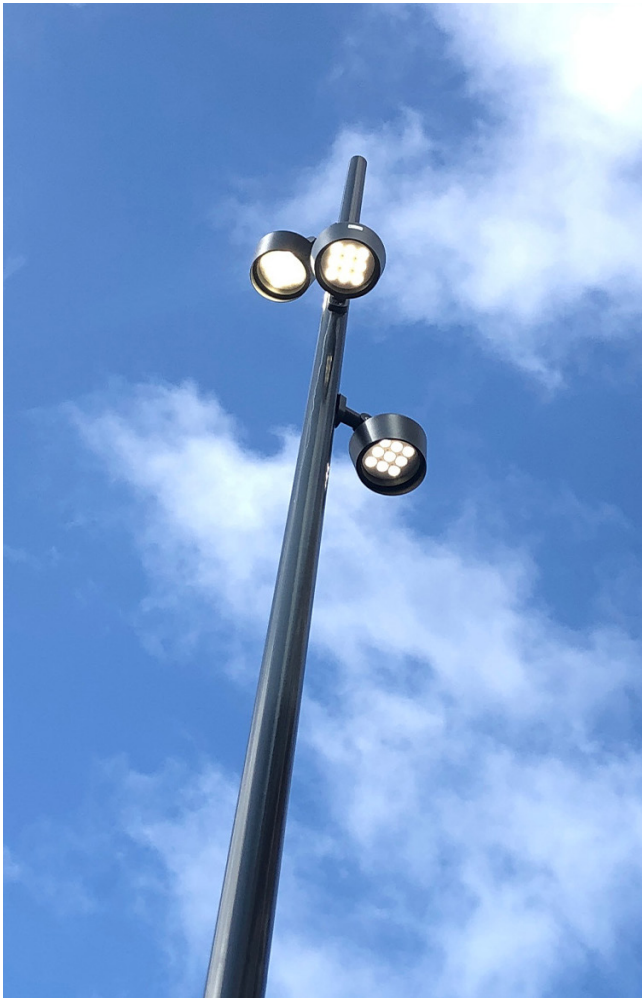
Downlight på mast
